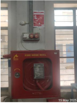
Fire Hoze reel Box .jpg
